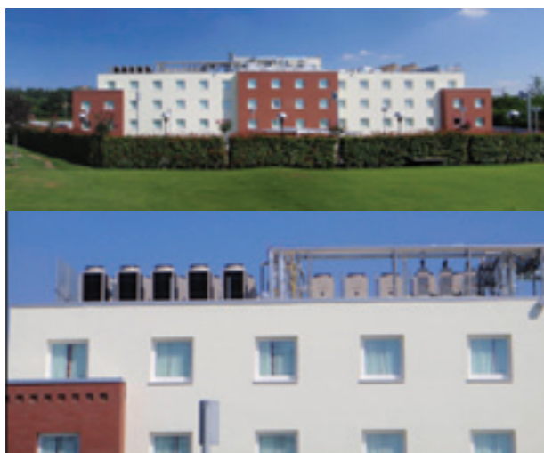
HOLIDAY INN EXPRESS BERGAMO WEST, MOZZO (BG). SONO STATI INSTALLATI 5 GRUPPI AD ASSORBIMENTO PREASSEMBLATI COSTITUITI DA POMPE DI CALORE AD ARIA REVERSIBILI, REFRIGERATORI PER RAFFREDDAMENTO E CON RECUPERO DI CALORE. I GRUPPI SONO STATI POSIZIONATI SUL TETTO, EVITANDO L'UTILIZZO DI SPAZI TECNICI INTERNI.
