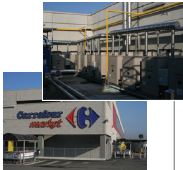
CARREFOUR DI CUSAGO (MI) CON POMPE DI CALORE AD ASSORBIMENTO REVERSIBILI ROBUR A GAS METANO ED ENERGIA AEROTERMICA
