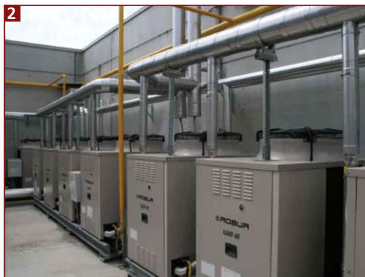
2. POMPE DI CALORE AD ASSORBIMENTO A GAS INSTALLATE PRESSO IL CARREFOUR MARKET DI CUSAGO.
