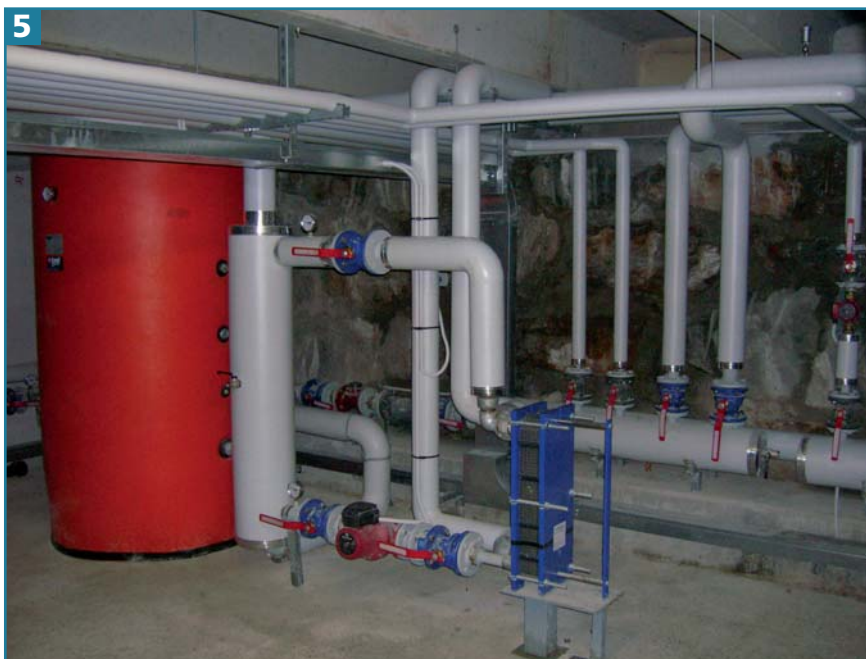
5. DETTAGLIO DELLA SOTTOCENTRALE DELL'IMPIANTO DI CLIMATIZZAZIONE CON POMPE DI CALORE AD ASSORBIMENTO.
