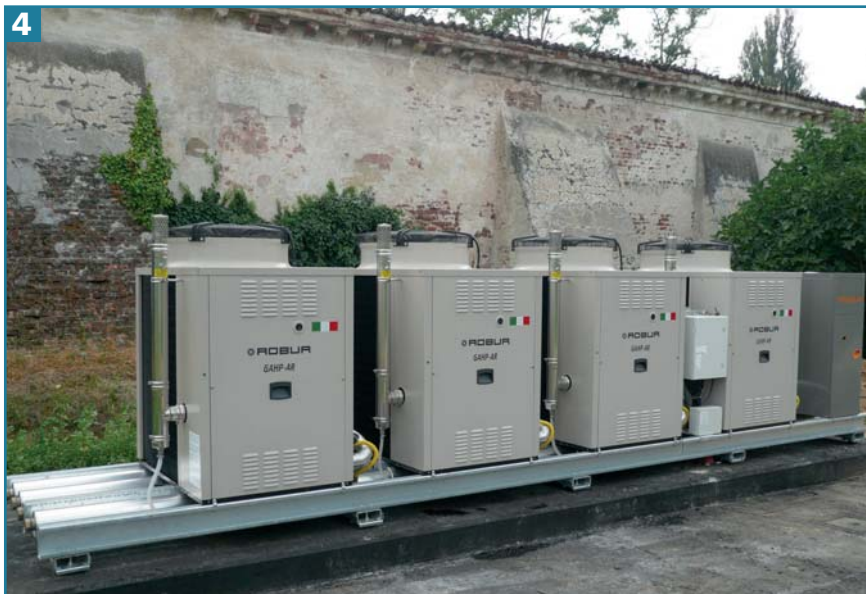
4. VISTA DELLE POMPE DI CALORE AD ASSORBIMENTO INSTALLATE PRESSO LA CERTOSA DI PAVIA.
