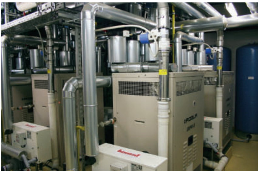
Abb. 1: Heizzentrale im Pastor-Braune-Haus: Die Wärmepumpen wurden kompakt in zwei Dreier-Reihen aufgestellt. Die Anlage mit 220 kW Heizleistung nimmt nur 12 m 2 Platz in Anspruch.
