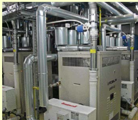
Kompakt aufgestellte Wärmepumpenkaskade, bestehend aus sechs Robur Sole-Wasser Gas-Absorptionswärmepumpen
